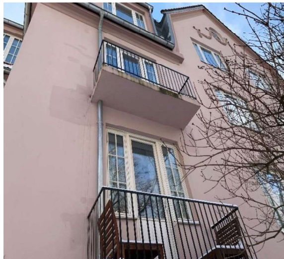
Foto 3: balkongdørfelt oppgang C
