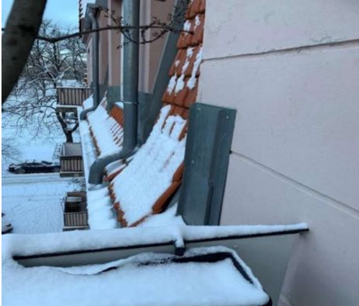
Foto 13: mansardtak på gavl syd (teglstein Koramic Pottelberg 44, nedløp og beslag av sink)
