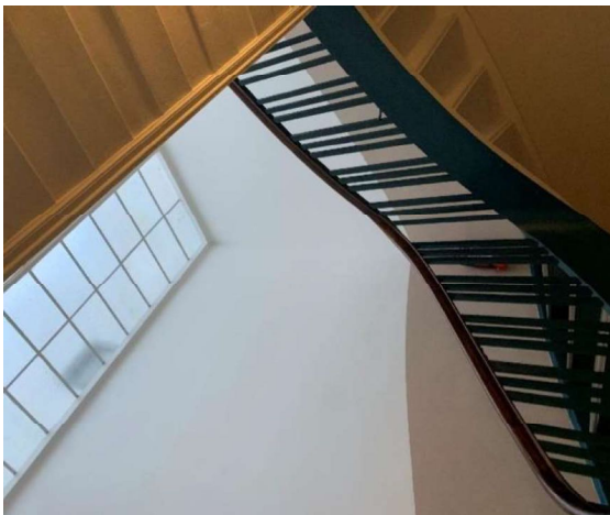
Foto 14: Undertak med glassfelt i oppgang A.
