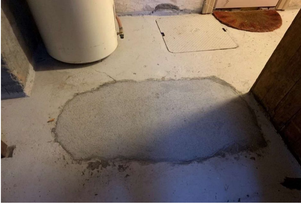
Foto 24: Kjellergulv i oppgang A hvor gulvet har vært pigget opp, stake kum i bakgrunnen
