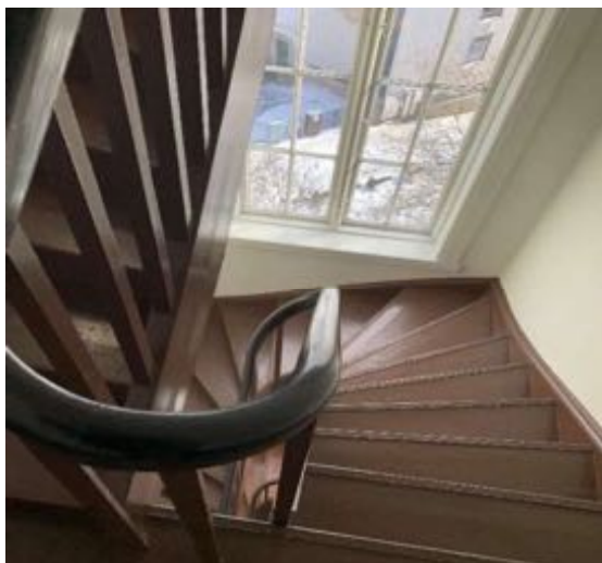
Foto 21: baktrapp oppgang C
