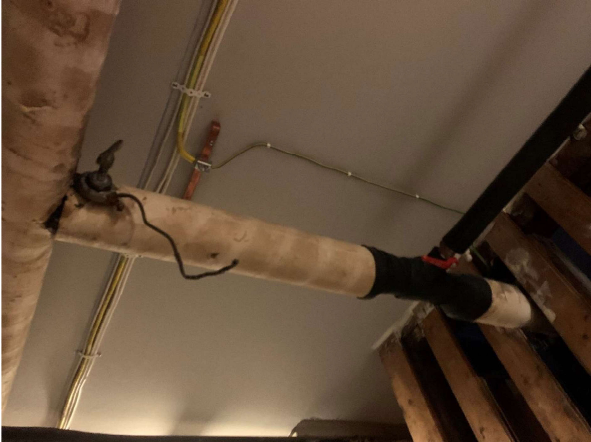
Foto 27: Opprinnelig avstenging av k.v opplegg med seteventilen til venstre er supplert med ny kuleventil til høyre
