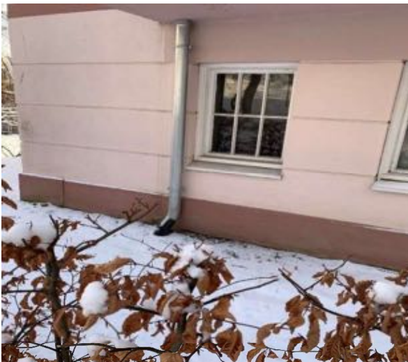
Foto 2: originalt kjellervindu, plastisolvannbrett
