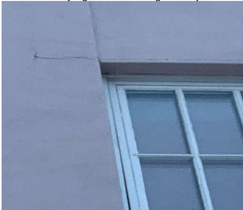
Foto 7: riss i overkant av vindu bakside, synlig delaminering av topp smyg
