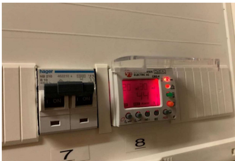
Foto 28: jordfeilalarm hovedfordeling BC
