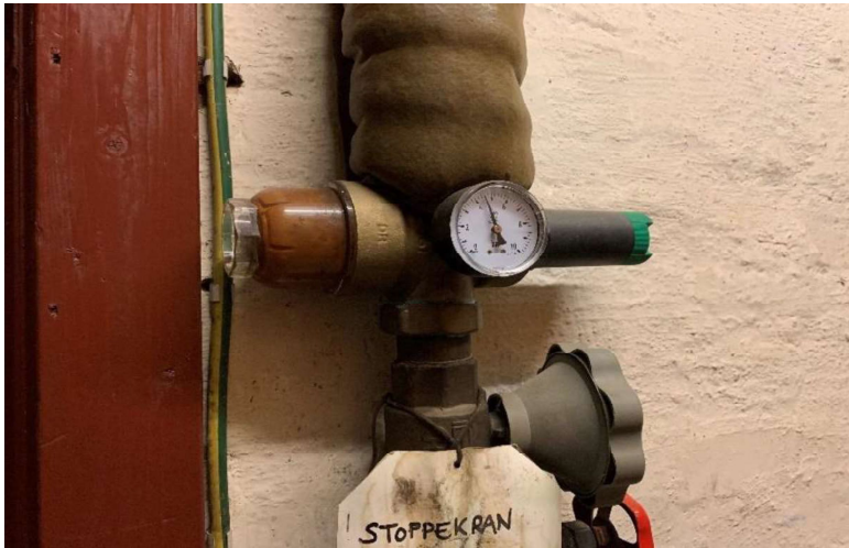
Foto 26: hoved stoppekran for bygget, filter bør rengjøres
