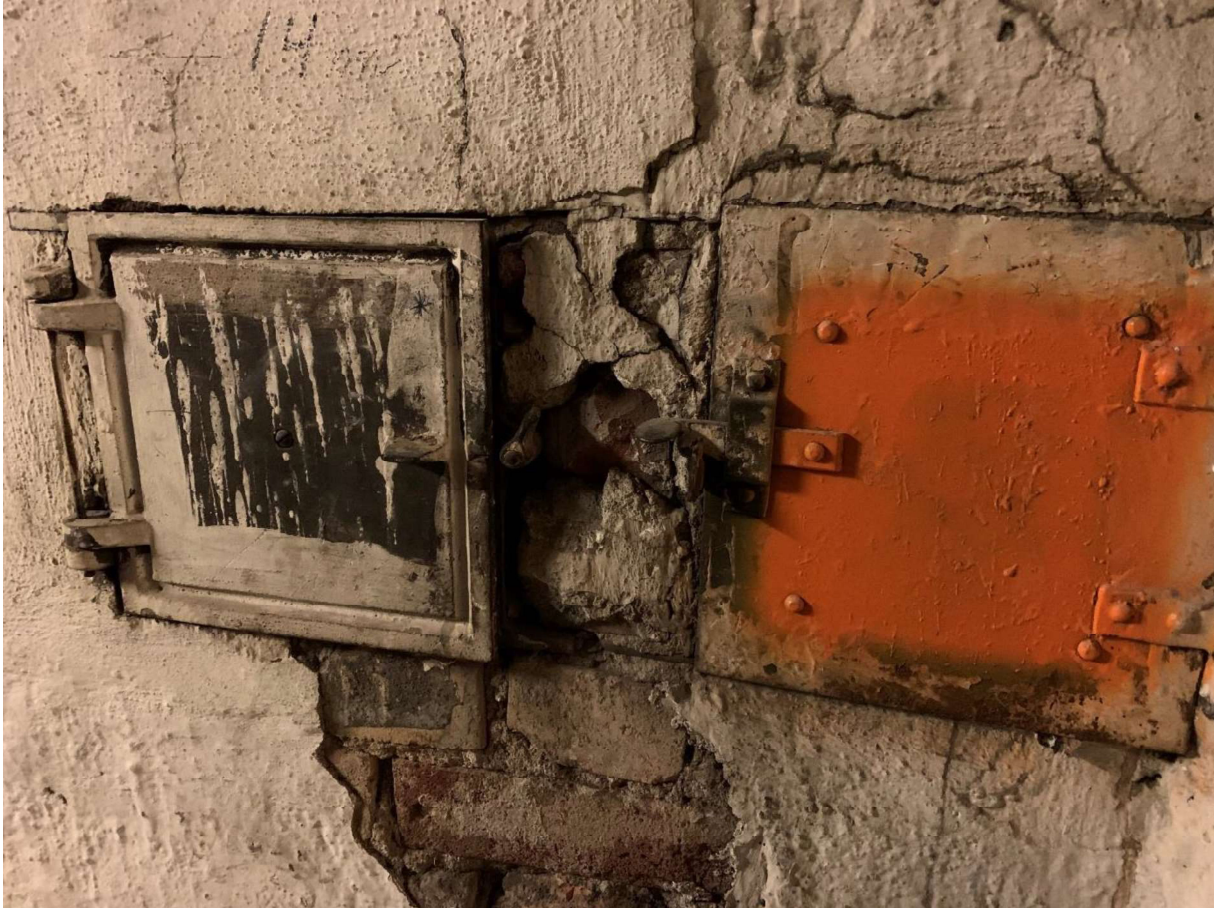
Foto 19: utett rundt sotluke i kjeller, må rehabiliteres dersom pipeløpet er i bruk
