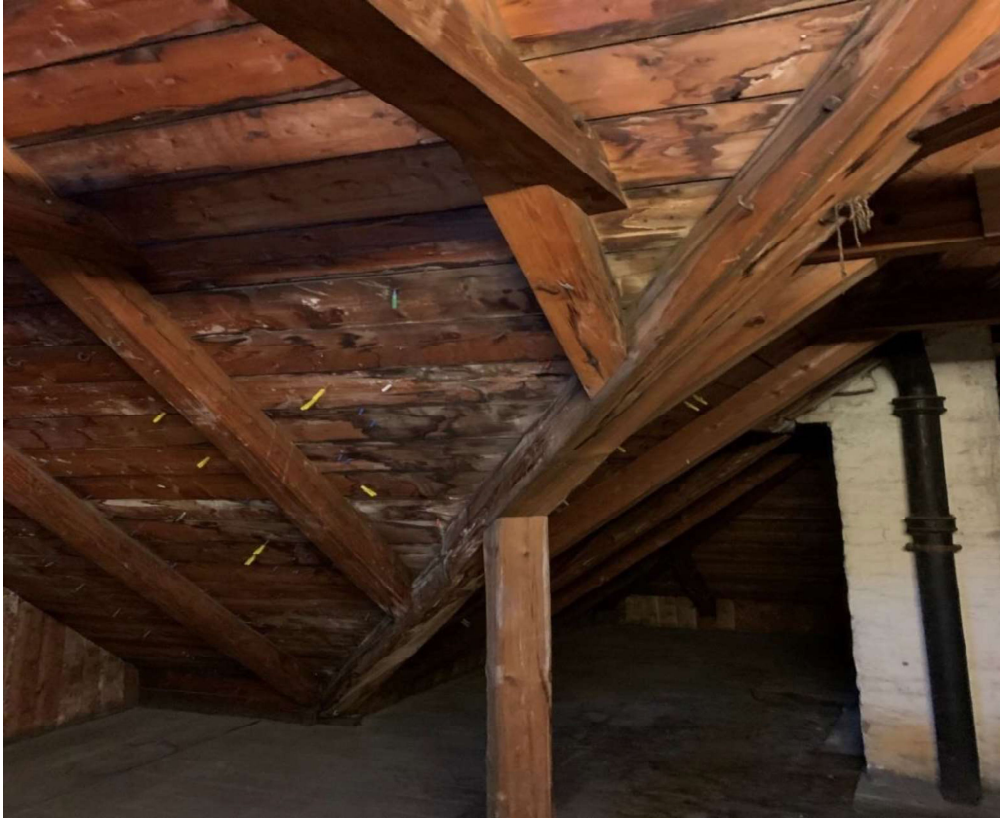
Foto 12: gamle fuktskjolder i rupanel i taktro (her ved gradrenne på loft C-oppgang)
