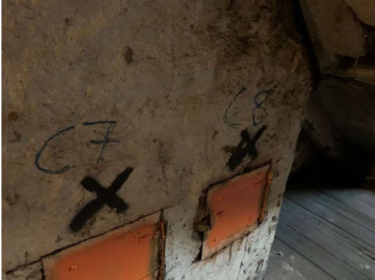
Foto 17: eksempel på merking av feieluker på pipeløp som er rehabilitert (loft i oppgang C)
